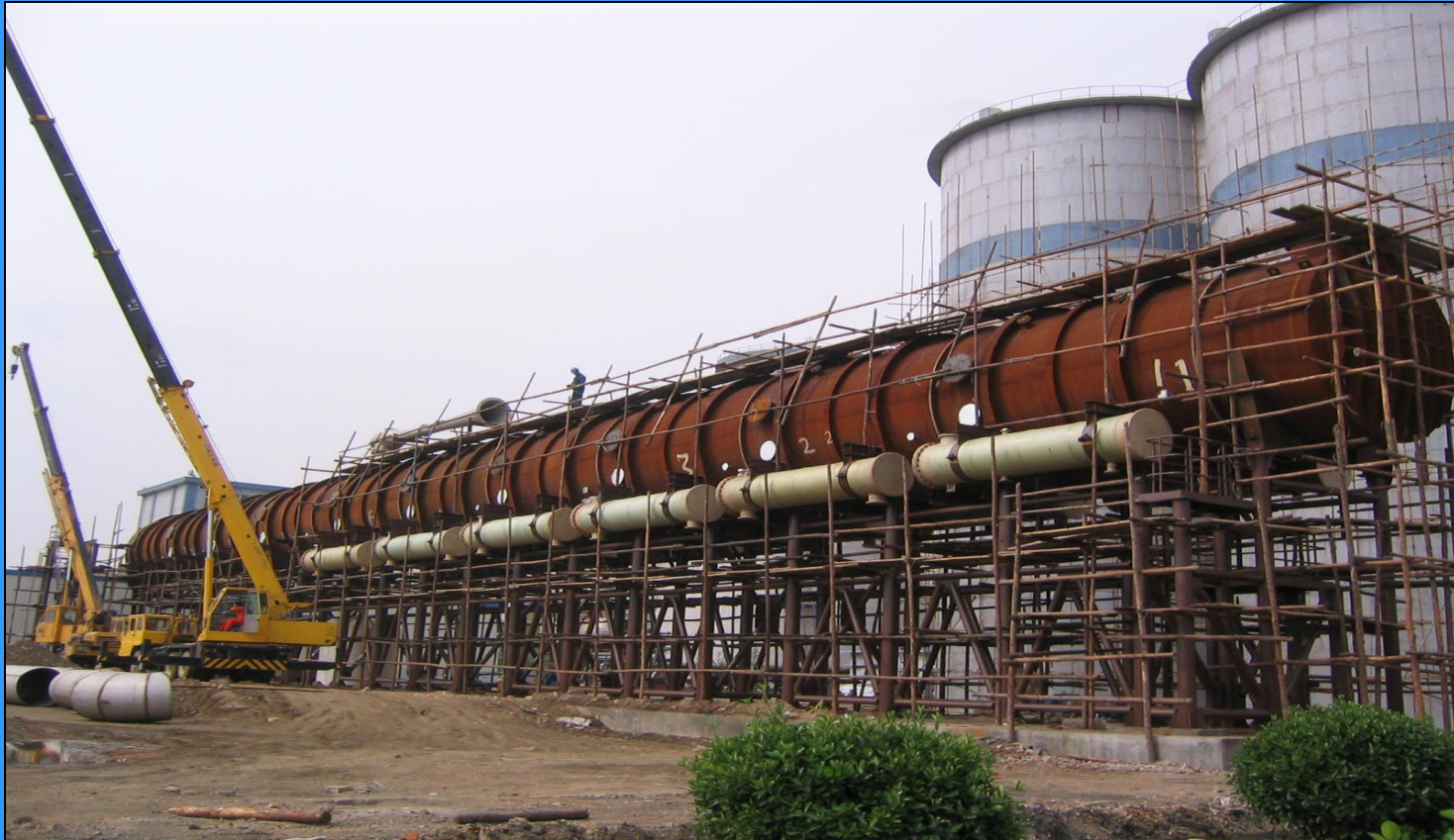
黄岛电厂3000m 3 /d低温多效蒸馏海水淡化装置 (2004)
